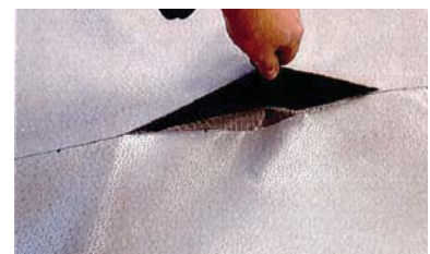
Rozwarstwienie złącza na zakładzie
