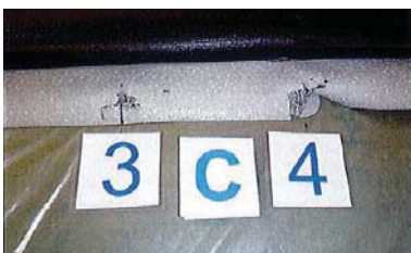
Wysunięcie membrany spod łącznika mocującego
